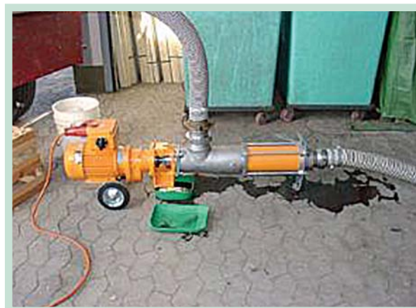
Fig. 63: Pompe à moût transférant le moût fermenté à la presse.
