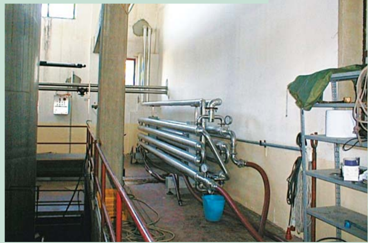
Fig. 65: Equipement technique pour échauffer et refroidir (Echangeur de température tubulaire).
