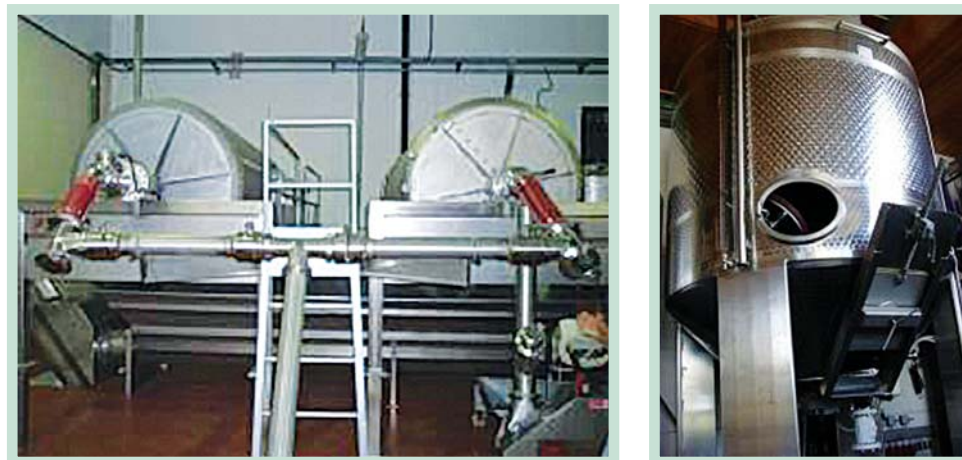
Fig. 69: Vins rouges - Cuves de macération: cuve rotative (gauche); cuve à immersion en inox (droite)
